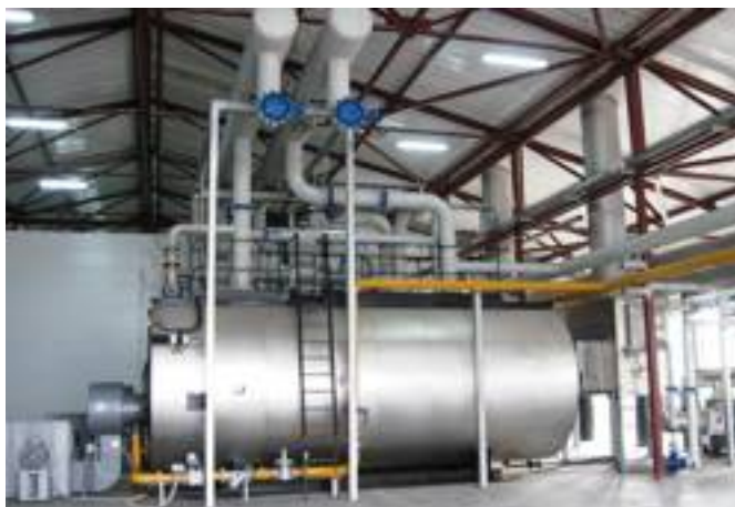
Centrale termica con 2 caldaie da 10 MW di potenza ciascuna, sufficiente per circa 20 ha di serra tecnologica in doppio film. A sinistra il bruciatore a metano, a destra il condensatore per il recupero della CO 2 dai fumi di combustione e il ventilatore per la sua distribuzione in serra. La condensazione dei fumi del metano porta l'efficienza della caldaia al 97%, in quanto recupera il calore latente al camino (se si brucia gasolio l'efficienza scende ca. all'80%).
