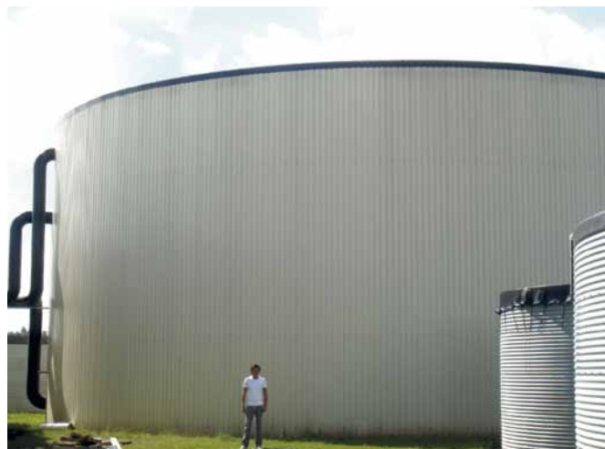
Enorme buffer da 6.000 m 3 per stoccare il calore prodotto di giorno da un impianto Chp, in forma di acqua calda a 90 °C, per riutilizzarlo di notte per riscaldare la serra. Un buffer al servizio di un impianto Chp ha volume circa doppio di uno accanto a una caldaia tradizionale.
