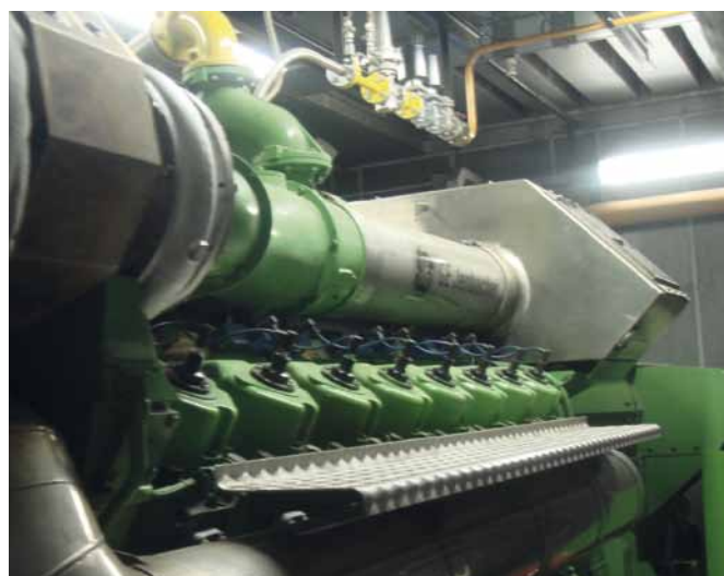
Motore endotermico per la produzione combinata di energia elettrica, calore e CO 2 (Chp, Combined heat and power ). L'energia elettrica può essere venduta con 3 tipi di contratti: a lungo termine, del giorno dopo, del giorno stesso ogni 15'. In questo modo il serricoltore può cercare di speculare sul mercato di gas ed energia per realizzare dei profitti finanziari.
