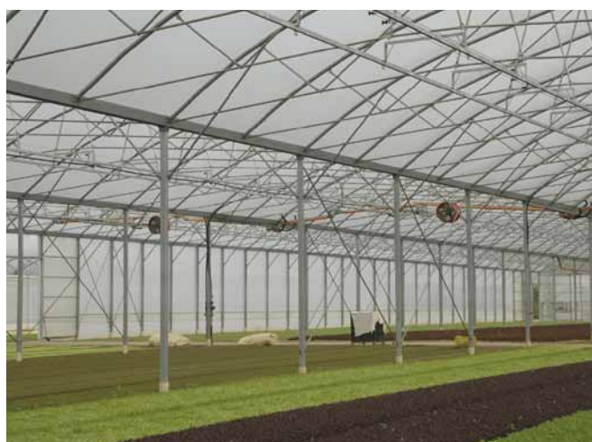
Ventilatori collocati lungo l'asse della serra spingono l'aria calda dalla zona dei bruciatori all'estremo opposto della struttura.
