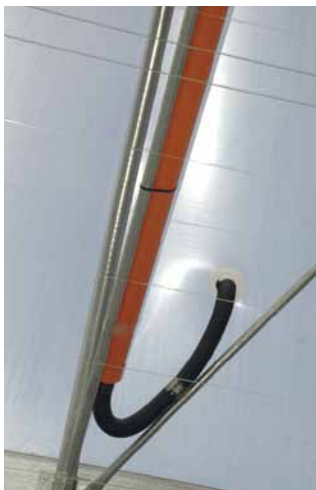
Particolare del sistema di gonfiaggio dell'intercapedine presente tra i teli di copertura.
