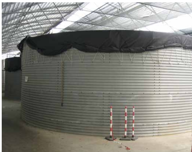
Due tank da 100 m 3 ciascuno assicurano l'immediata disponibilità di acqua per l'impianto di fertirrigazione.
