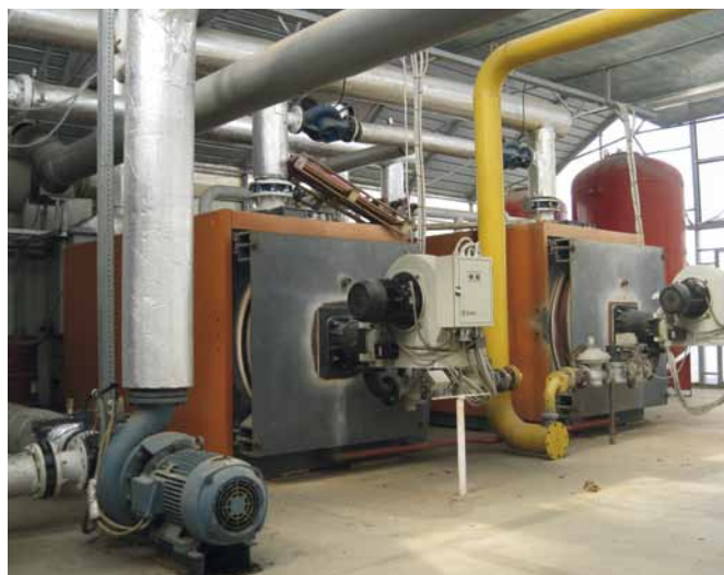
Due caldaie a gas metano, di 2,5 e 2 milioni di chilocalorie, producono l'acqua calda per il riscaldamento della serra.
